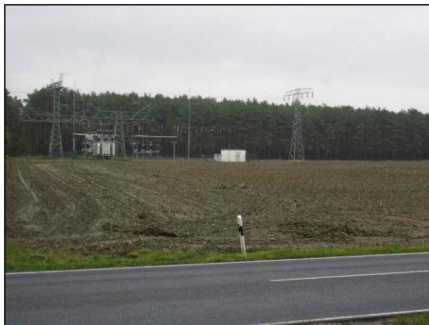
Abb. 27 Umspannwerk in der Versorgungsfläche H3 (10/2016)
