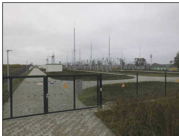
Abb. 35 Betriebsgelände des Umspannwerkes edis (10/2016)
