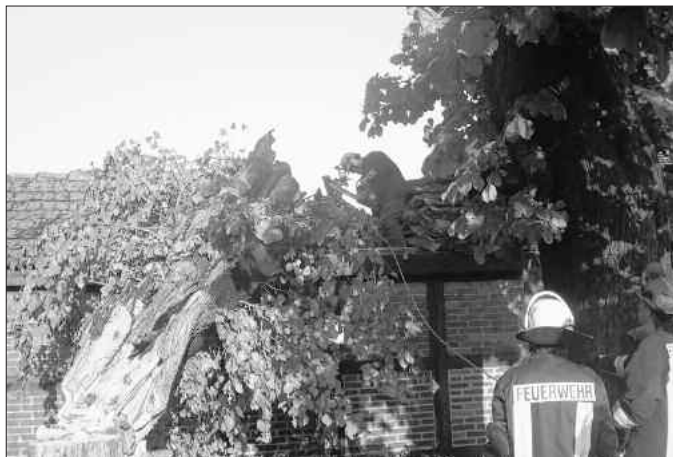
Eine umgestürzte Eiche musste von einem Anbau entfernt werden. (Foto: FF Baruth/Mark)
